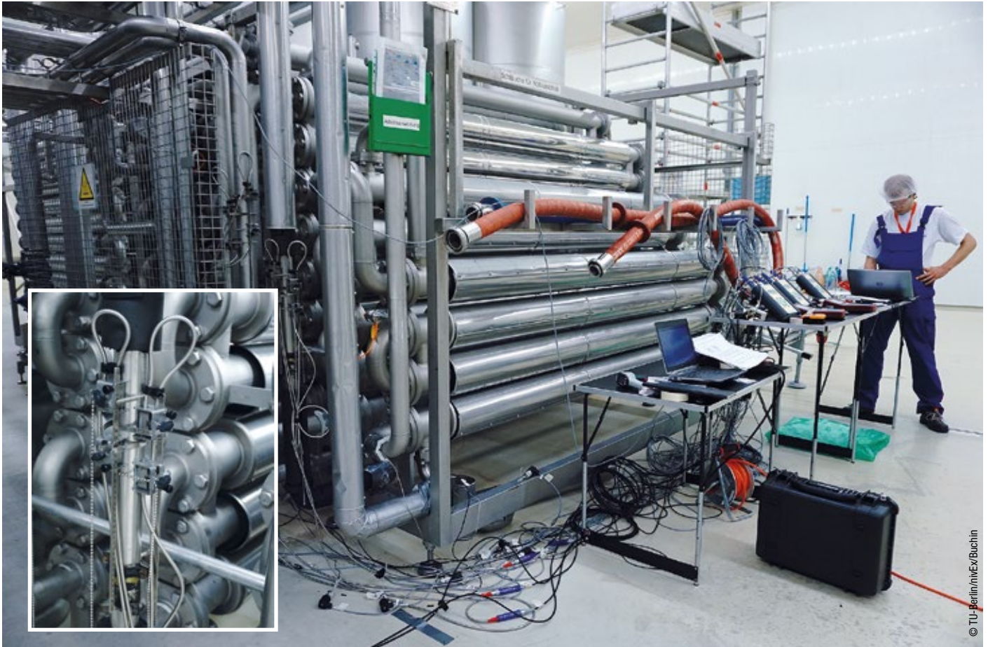
Abb. 1a+b: Clamp-On Durchflussmessung (1a) an einem Doppelrohr-Wärmeübertrager (1b) (ADM WILD Europe)
